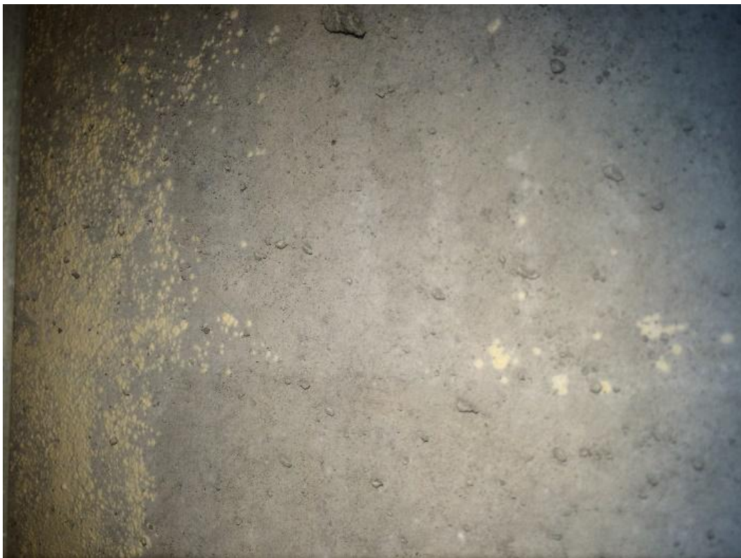
Mynd 6. Mygla á yfirborði steypis útveggs í nýlegu húsi.
