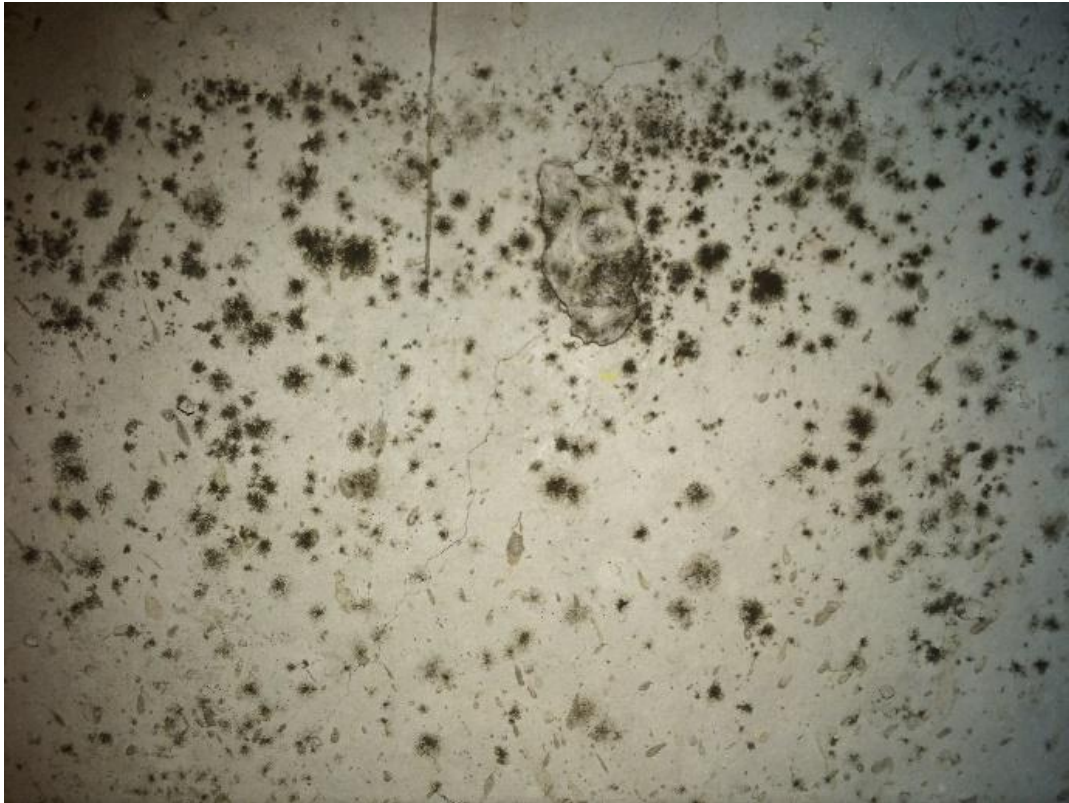
Mynd 5. Mygla á yfirborði steypis útveggs í nýlegu húsi.
